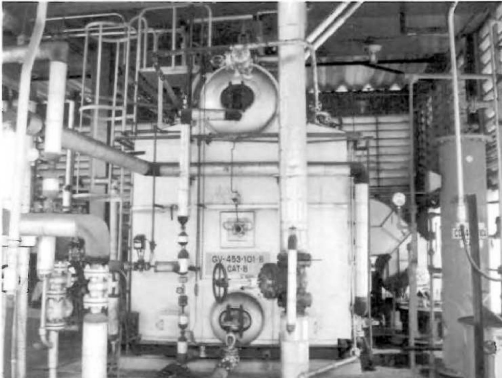
Nº 238- GV-453101 B- Caldeira DEDINI, tipo aquatubular -cap: 120 ton/h (Área do TDC – produto Óleo Combustível).
