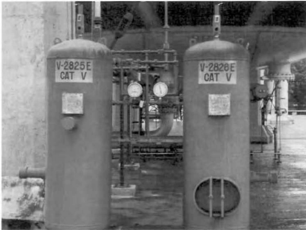
Nº113- V-28- Vasos acumuladores de ar comprimido – (Área GLP- Esferas) Peso vazio= 257 Kgs
