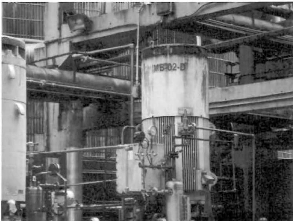
Nº 188- B-02 D- Bomba centrífuga vertical, vazão 233 m 3 /h Ingersol Rand, Motor 185 KW. (Área GLP).
