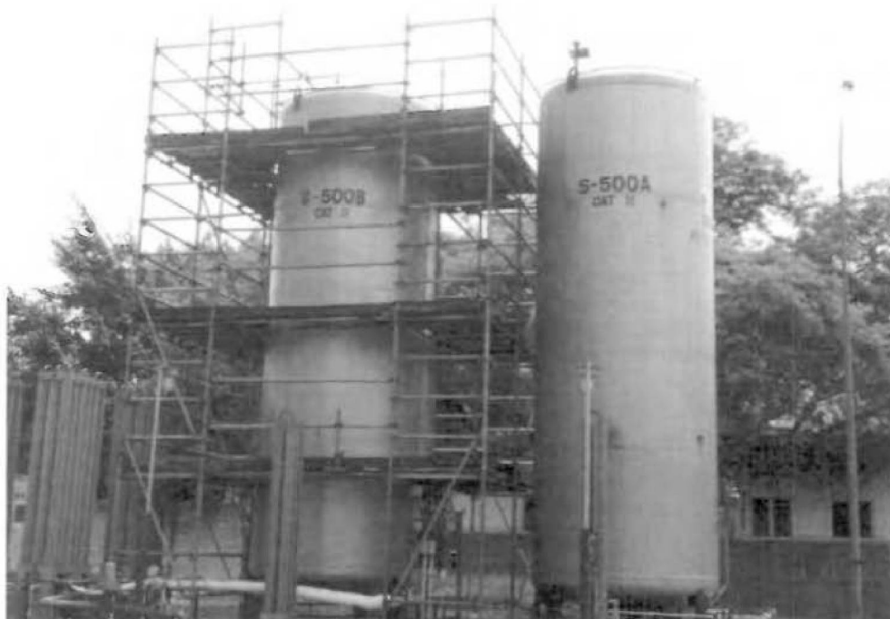
Nº117- S-500A/B- Vasos Criogênicos (armazenamento de nitrogênio) –GLP Peso vazio= 5356 kgs
