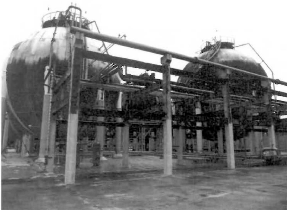
Nº.60 – Bases e estruturas das esferas de GLP (3200m 3 )
