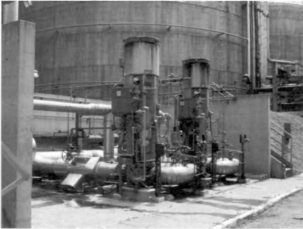
Nº 194- B-06 A/B – Bombas verticais Ingersol Rand, vazão 233 m 3 /h, Motor 185 KW (Área GLP).
