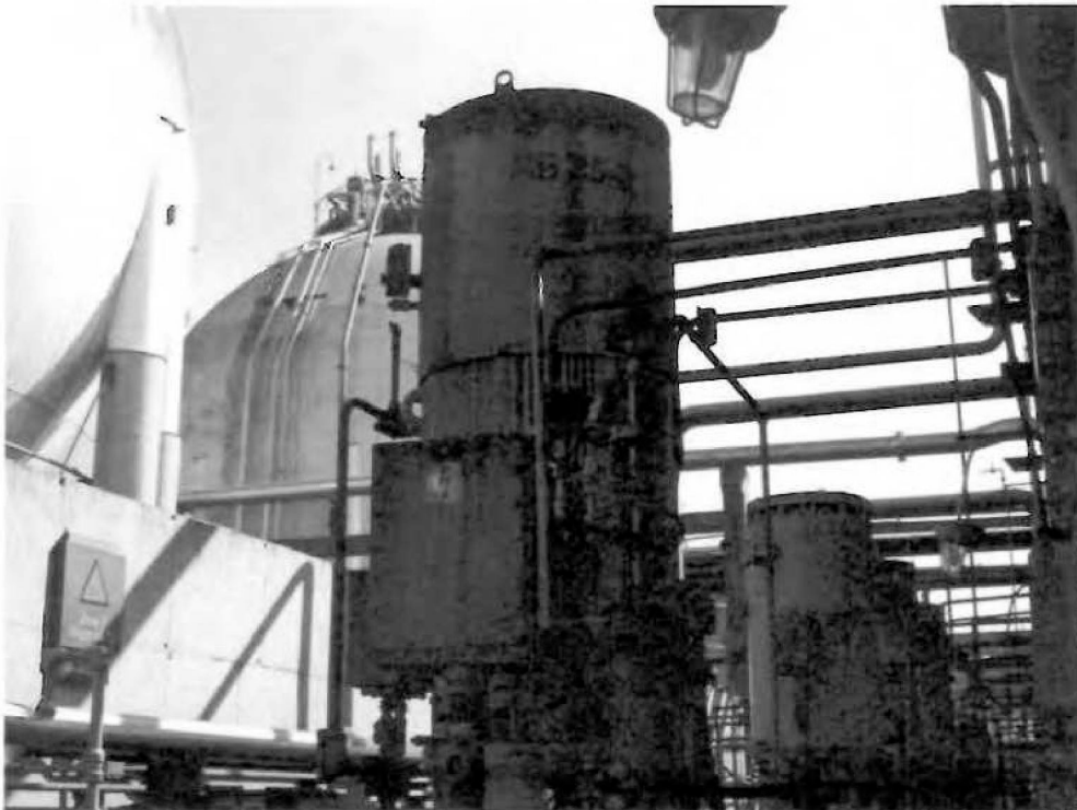
Nº 193- B-05 D- Bomba centrífuga vertical Ingersol Rand, vazão 233 m 3 /h, Motor 185 KW (área GLP).
