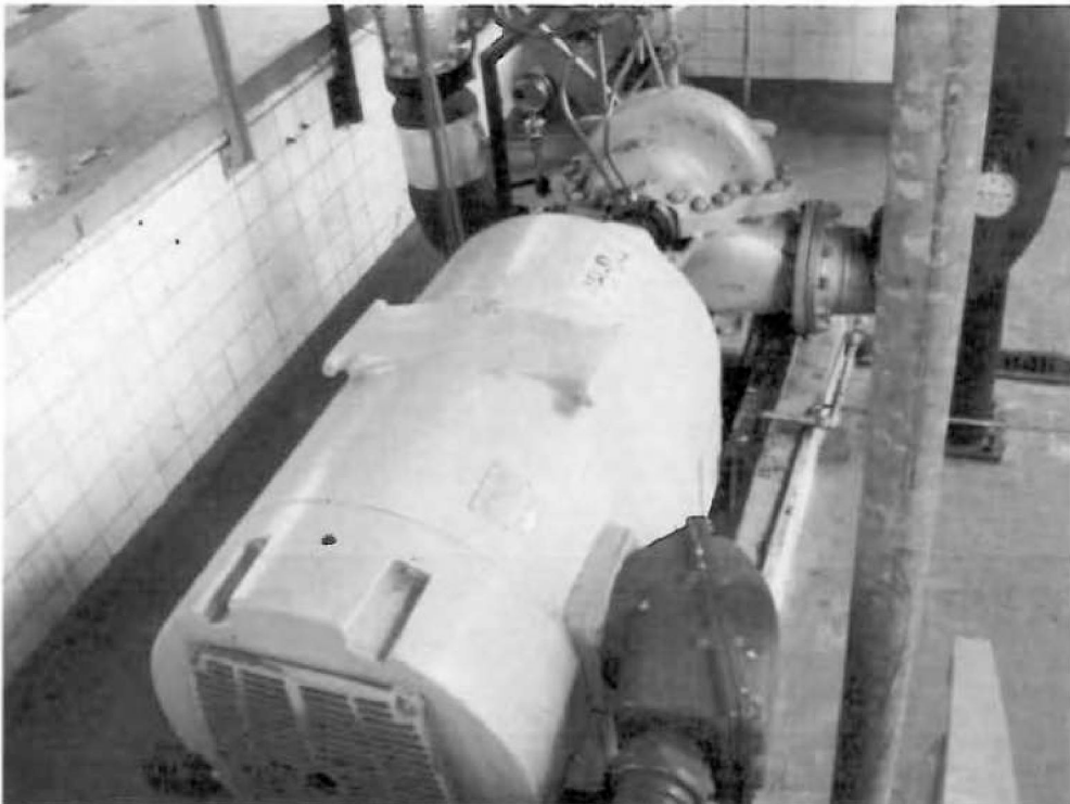
N° 229- BB-84- Bomba Worthington, vazão 550 m 3 /h, motor 300 cv. (Área da ALEMOA – produto Óleo Combustível).
