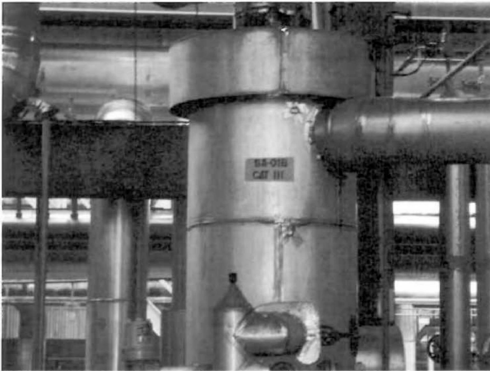
Nº72- AS-01 A/B/C/D - Vaso de Sucção vertical (Área: GLP) Peso vazio= 750 Kgs
