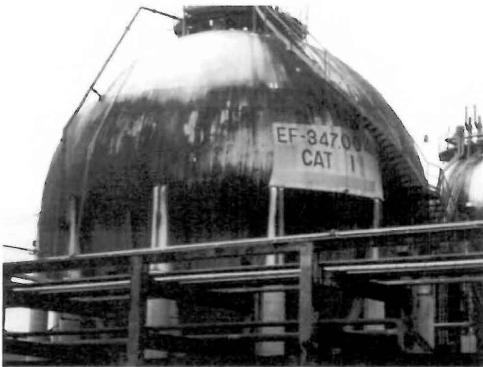
Nº 217- EF- 347004- Esfera de GLP, capacidade = 3.198 m3. (Área GLP)
