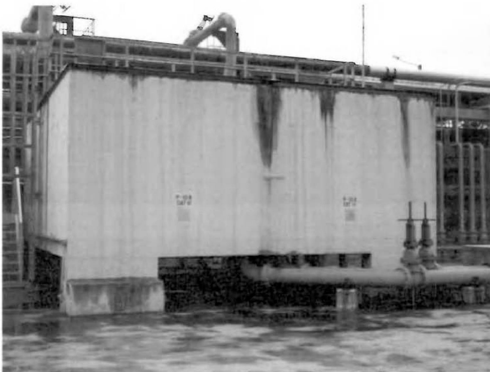
Nº131- P-10 A/B – Trocador de Calor- Trombone Heater (Área GLP).
