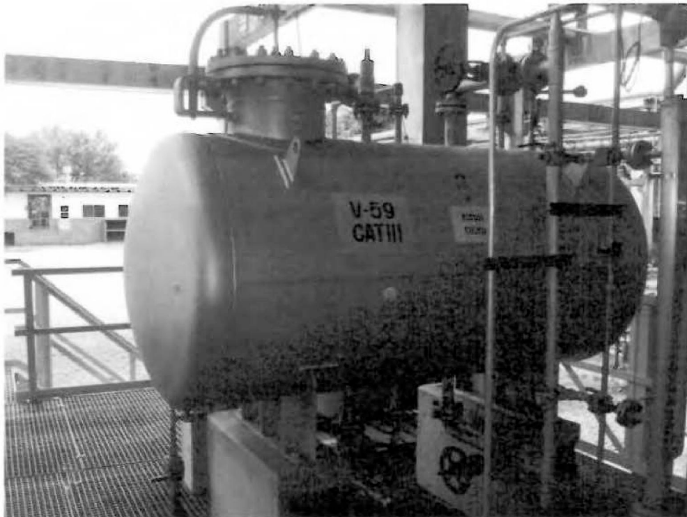
Nº133- V-59 – Vaso de Pressão (Armazena álcool etílico hidratado/anidro) –GLP Peso vazio= 950 kgs
