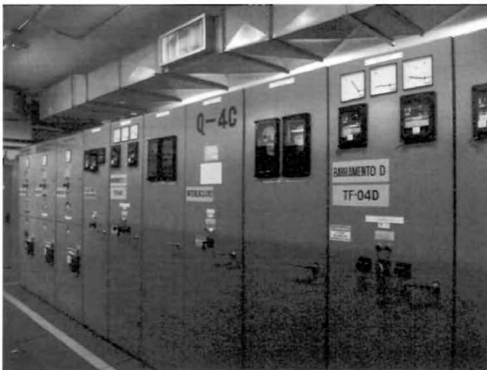
Nº256 - Q 4 C – Quadro de força – Promon de 4,16 Kv, 10 saídas 7,5 MVA – 2,3 MVA. (Área TDC).
