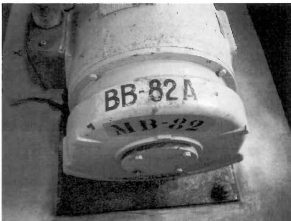
Nº 228- BB-82-A- Bomba Worthington, vazão 170 m 3 /h, motor 150 cv. (Área da ALEMOA – produto Óleo Diesel).
