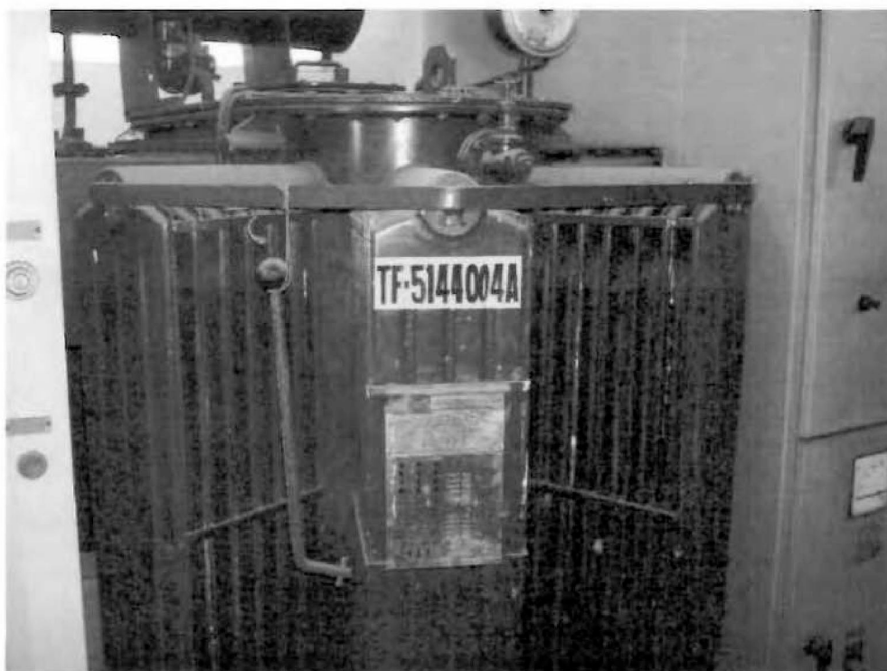
Nº 323- TF5144004A/B - Transformador fabricação Francisco Matarazzo. Tipo óleo mineral, 13800/440 V - 750 Kva
