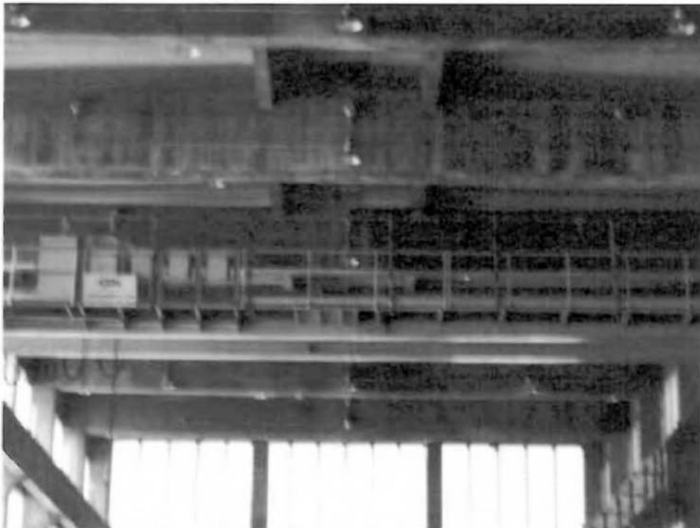
Nº 197- CR-01- Ponte Rolante com vão de 15,84 m e capacidade de 15 ton. (Área GLP).
