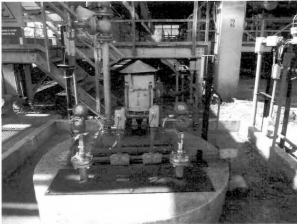
Nº136- B-180 – Bomba Vertical Worthington de 7,5 hp.- GLP.
