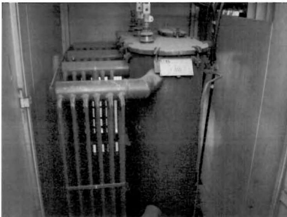
Nº 322- TF5144004 - Transformador fabricação Itel. Tipo óleo mineral, 440/220 V - 225 Kva.
