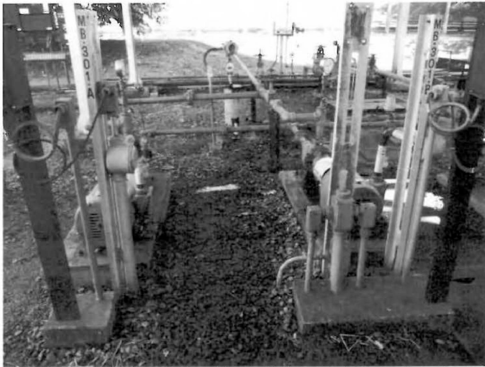
Nº 143- B 301 A/B- Bomba Worthington 8,61cv (elétrica)- combate a incêndio (Área TDC).
