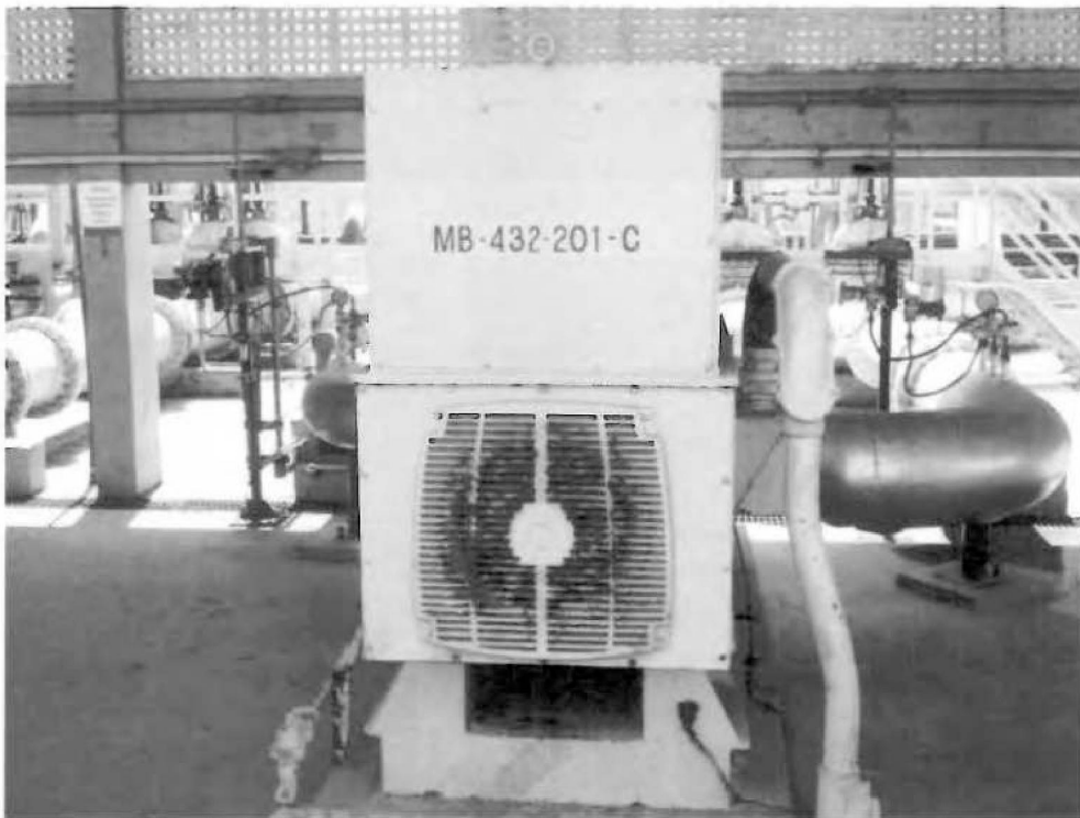
Nº 302- B 432201 A/B/C – Bomba de 700 hp, motor GE 700 hp. (Área COTAL).
