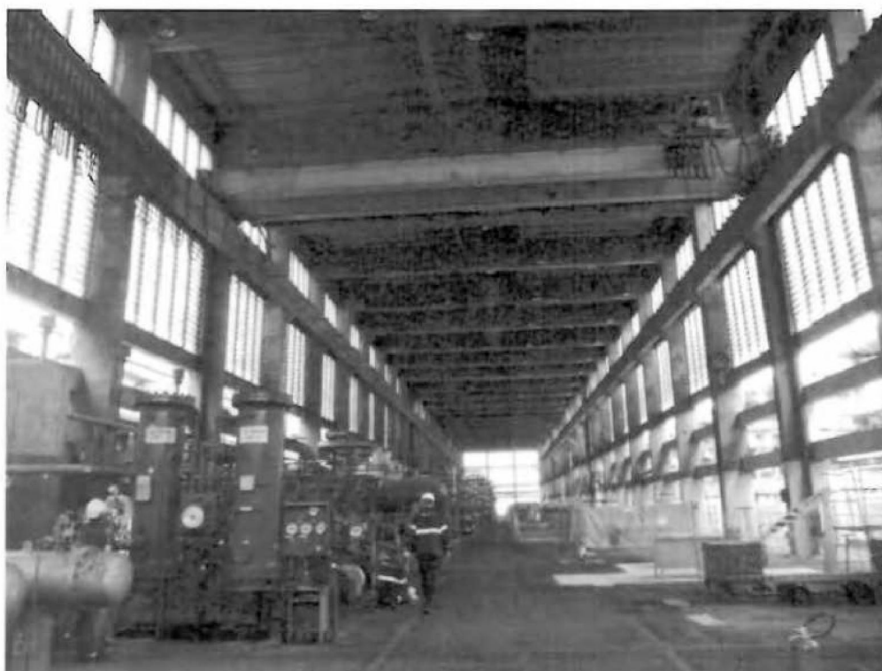
Nº.54 – Casa de máquinas
