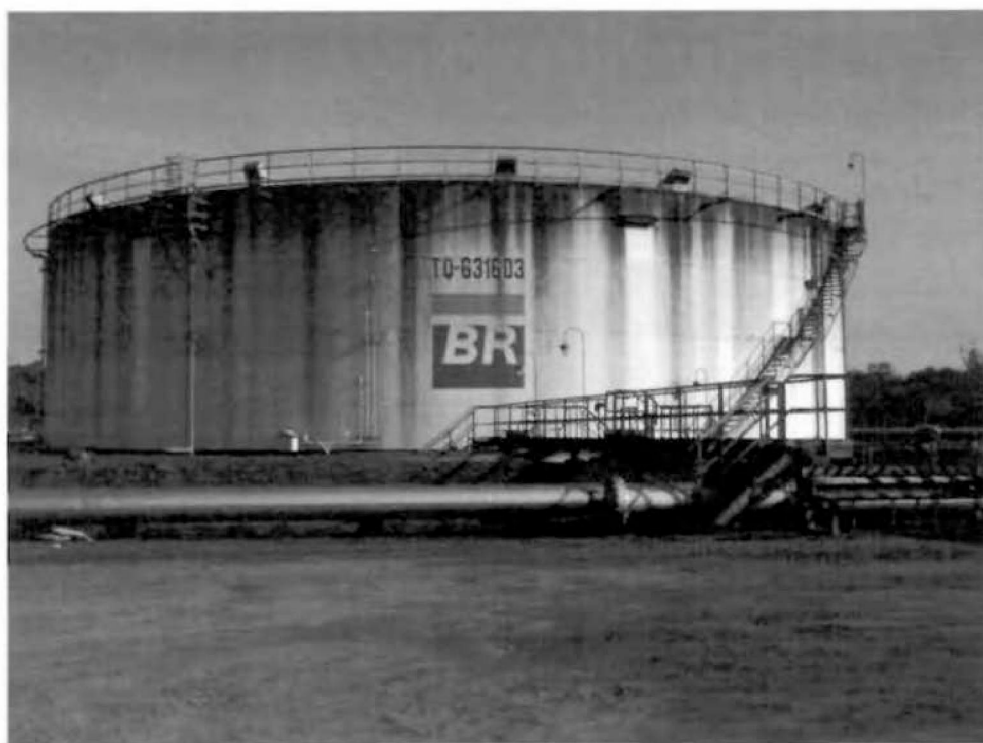
Nº 313/I- TQ 631603- Tanque para armazenamento de óleo diesel. Capacidade= 9.386 m 3 (Área Alemoa).
