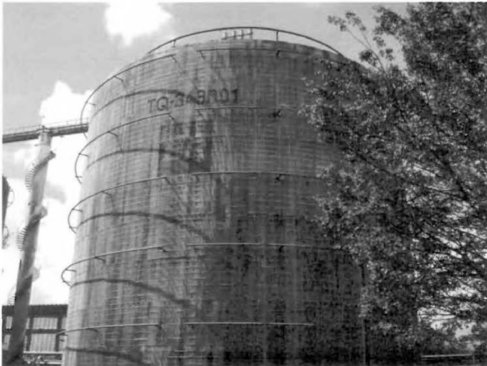
Nº 218- TQ- 349001- Tanques isolados para estocagem de GLP, 16.795 m 3 (Área GLP).
