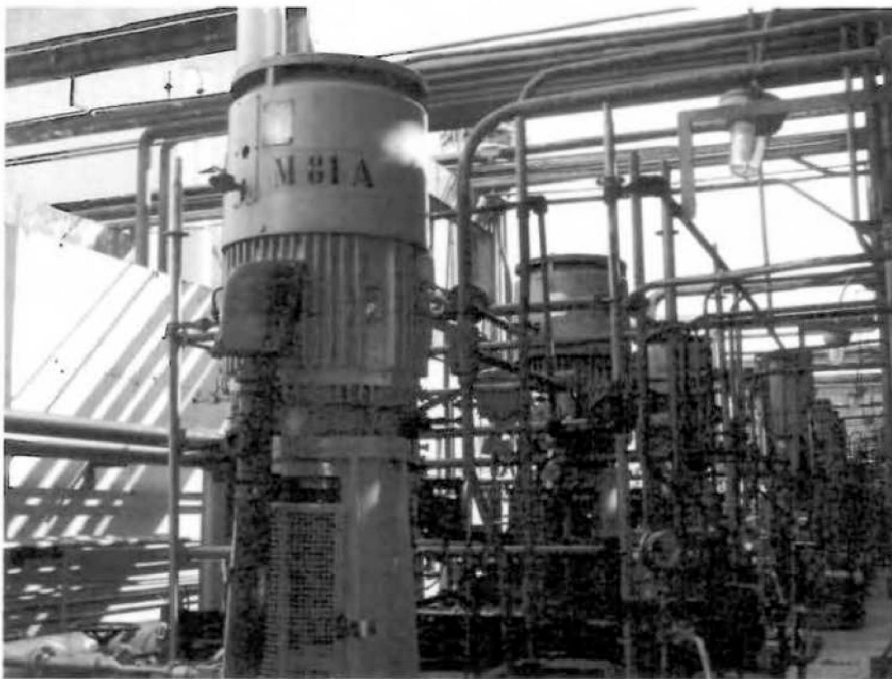
Nº 196- B-81 A/B/C- Bombas verticais Worthington, 75 cv, vazão 185 m 3 /h, Motor GE 100 HP (Área GLP).
