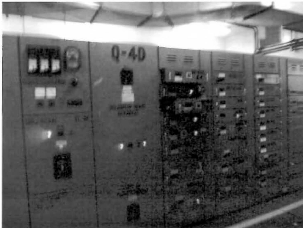
Nº257- Q 4 D- Quadro de força da SACE 480/220/127V – 60 hz- 34 saídas. (Área TDC).
