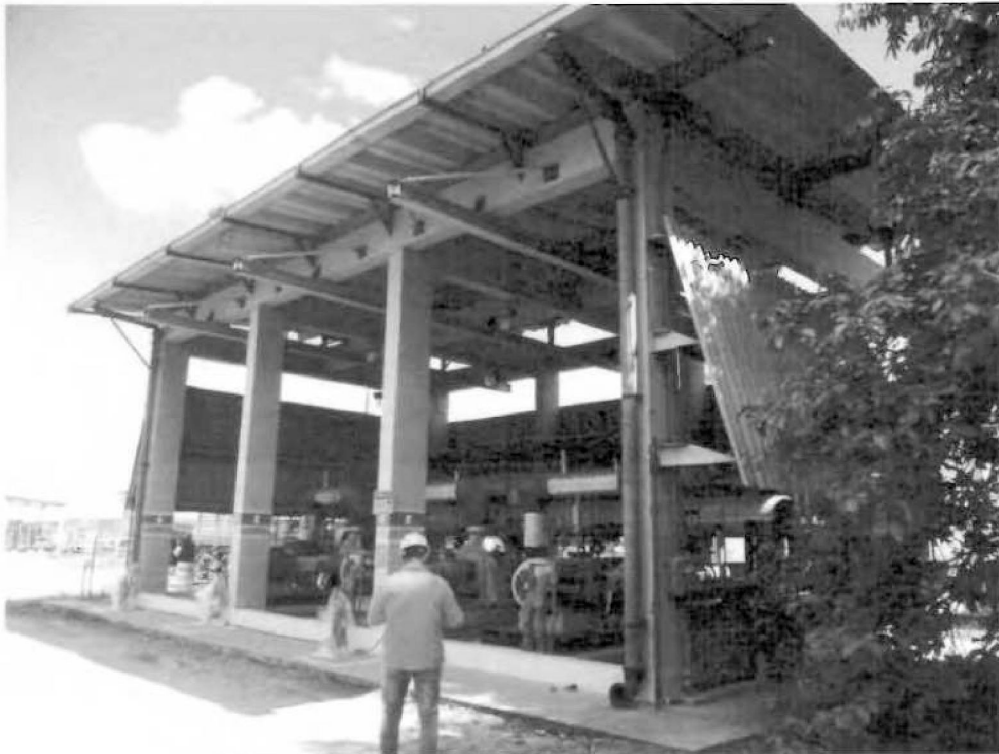
Nº.19 – Casa de bombas Bunker (bomba 701)
