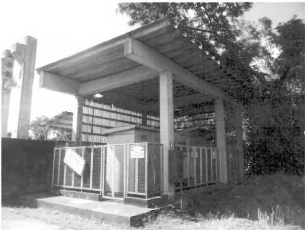
Nº.31 – Transformadores do canteiro de obra
