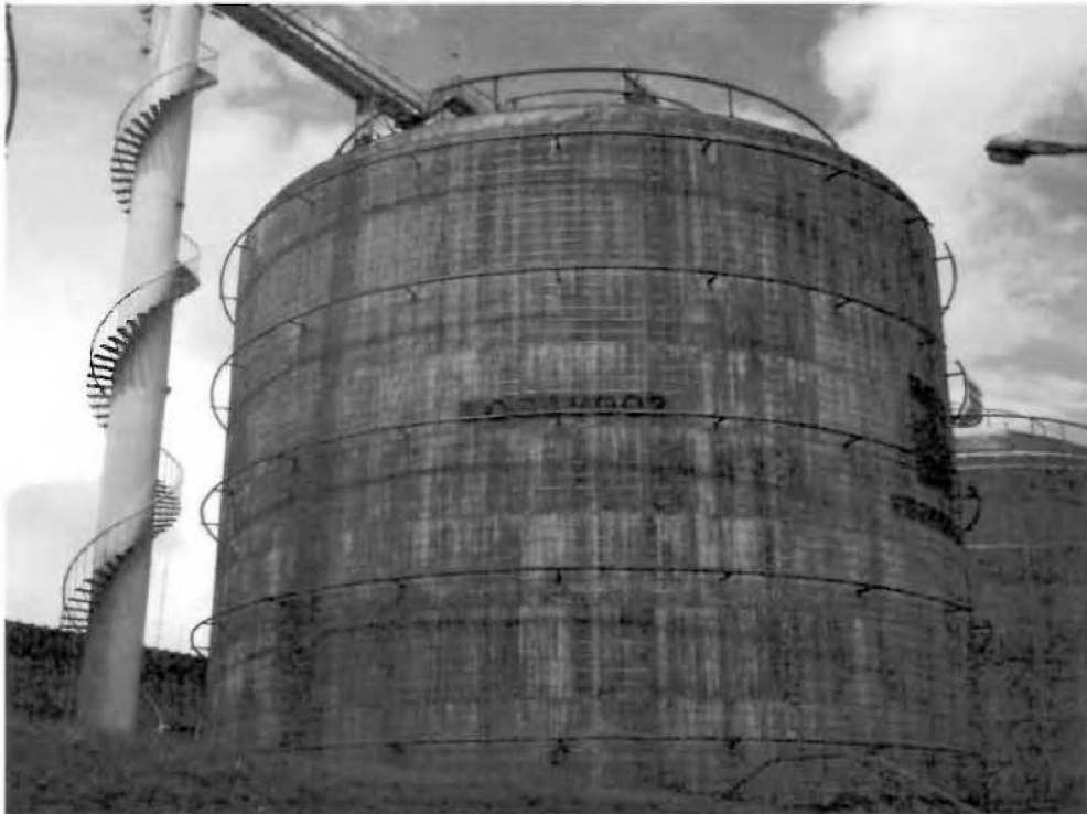
Nº 218/2- TQ- 349003- Tanques isolados para estocagem de GLP, 16.795 m 3 . (Área GLP).
