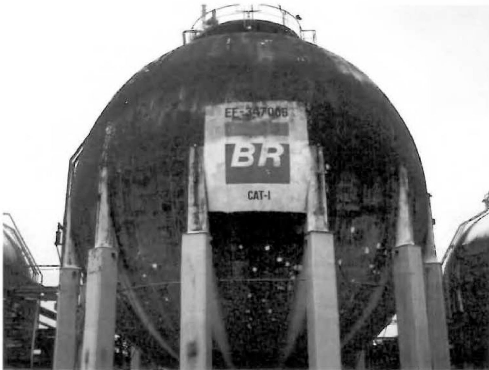
Nº 217/2- EF- 347006- Esfera de GLP, capacidade = 3.198 m 3 . (Área GLP)
