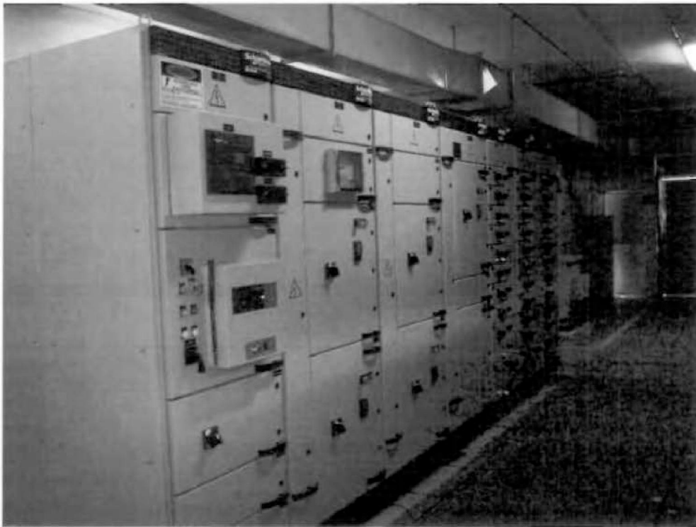
Nº 324-Q 5 E - CCM de baixa tensão, fabricação Schneider, Modelo Gama Blockset IP-31 forma 4B, 480 v, 1250 A, 41 saídas.
