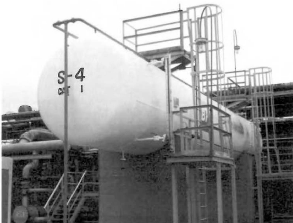
Nº 219- S-4- Reservatório de Propano Especial, volume 55,1 m 3 . Peso vazio= 19.200 Kg (Área GLP).
