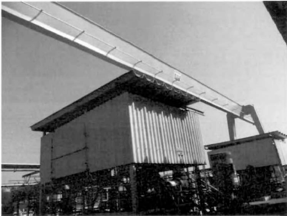
Nº 198- CR-02- Ponte Rolante com vão de 23 m e capacidade de 10 ton. (Área PIER).
