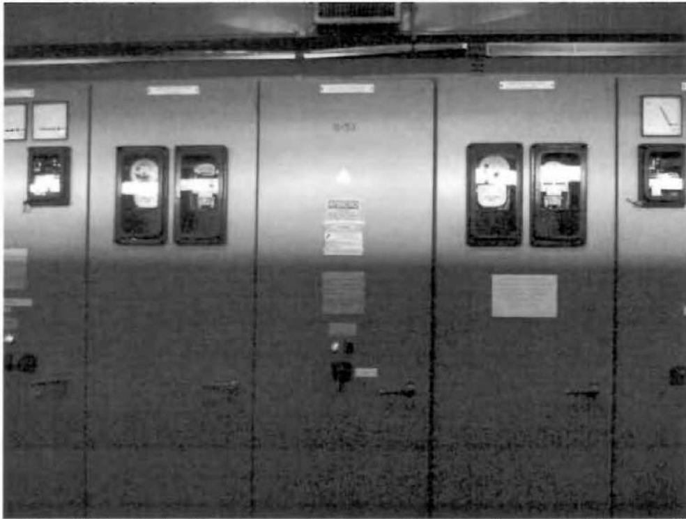
Nº163- CCM- Q 5 A/B – Quadro de Força GE – 18 saídas – 10 MVA – 3 MVA (Área GLP).
