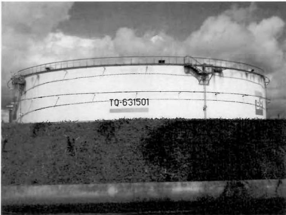
Nº 311- TQ 631501- Tanque para armazenamento de óleo diesel. Capacidade=22.500 m 3 (Área Alemoa).
