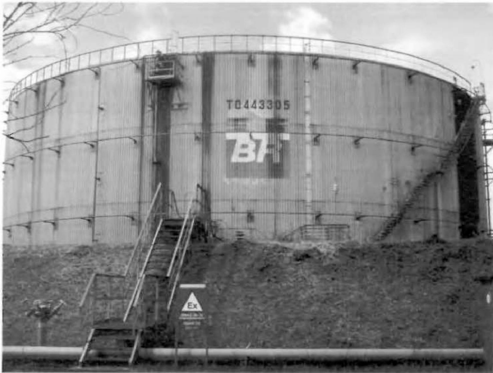
Nº 307/4- TQ 443305- Tanque para óleo combustível, com agitadores. Cap. 20.000 m 3 (Área TDC).
