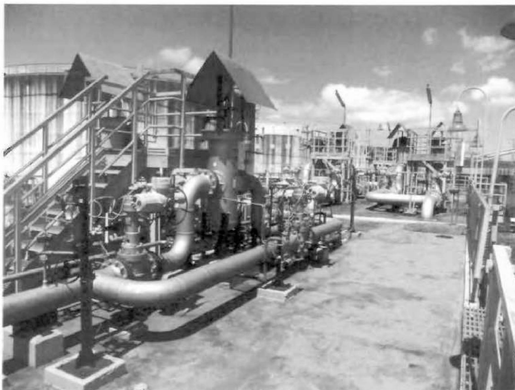
Nº.28 – Scraper Km 1 +300 (sistema de cabeça de dutos)
