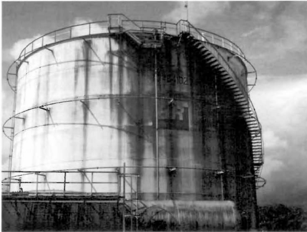
Nº 310/1- TQ 464102- Tanque para lastro. Capacidade= 6.649 m 3 (Área SAO).
