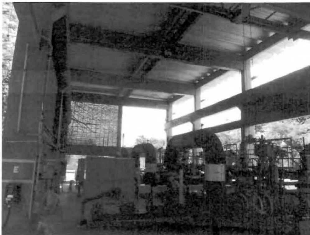
Nº.9 – Casa de Bombas 301
