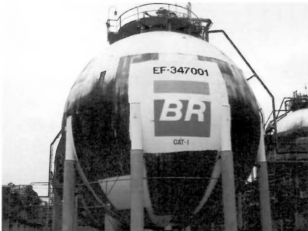
Nº 215- EF-347001- Esfera de GLP, capacidade = 1.593 m 3 (Área GLP).
