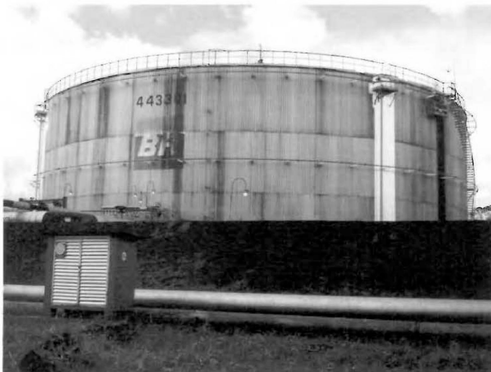
Nº 307- TQ 443301- Tanque para óleo combustível, com agitadores. Cap. 22.4659 m3. (Área TDC).
