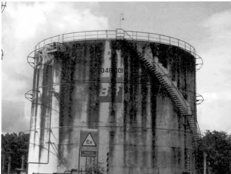
Nº 310- TQ 464101- Tanque para lastro. Capacidade= 6.651 m 3 (Área SAO).
