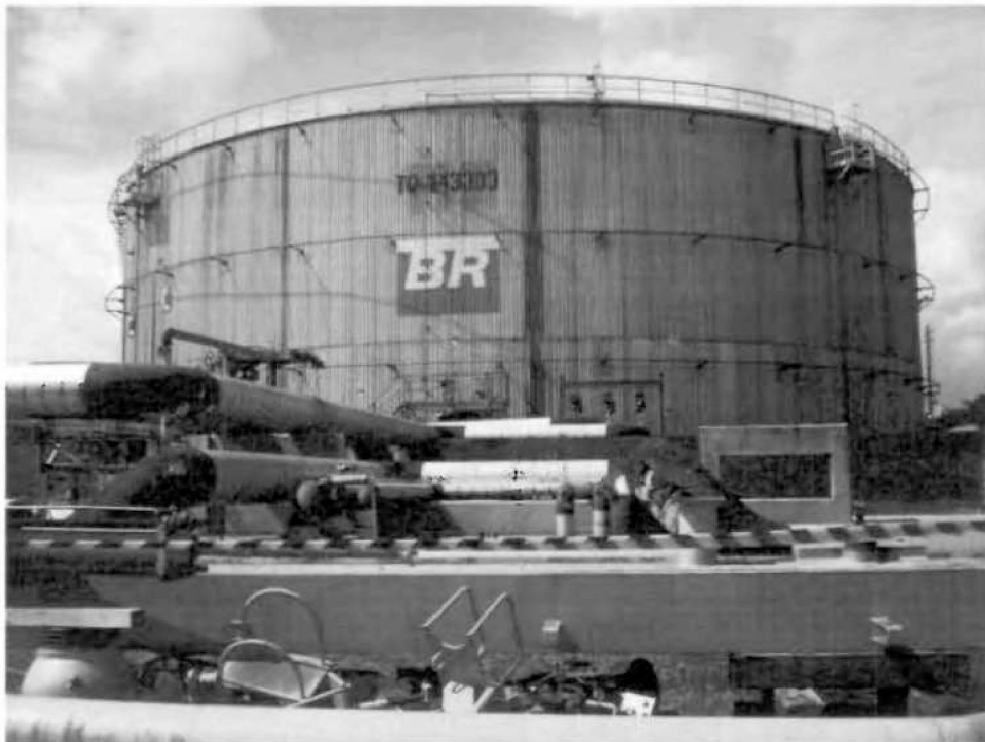
Nº 307/2- TQ 443303- Tanque para óleo combustível, com agitadores. Cap. 22.4659 m3 (Área TDC).
