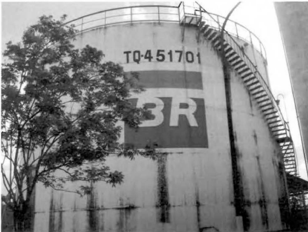
Nº 139- TQ-451701- Tanque cilíndrico de água tratada (Área TDC).
