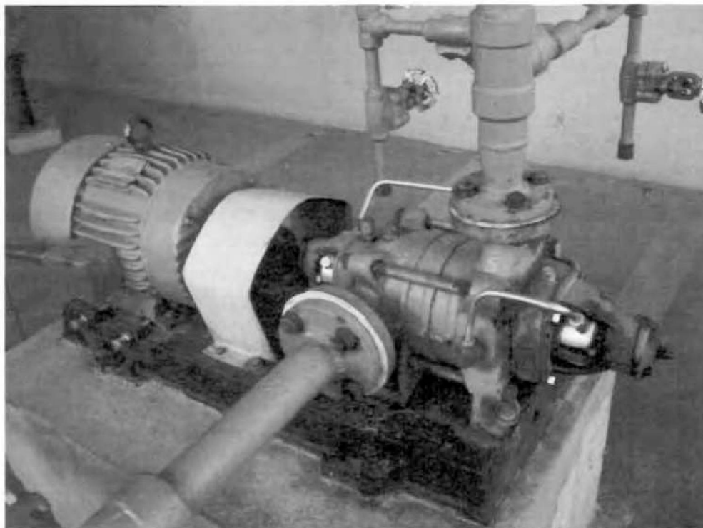
Nº 144- B 468501 A- Bomba Sulzer de 44 HP- combate a incêndio (Área SAO).
