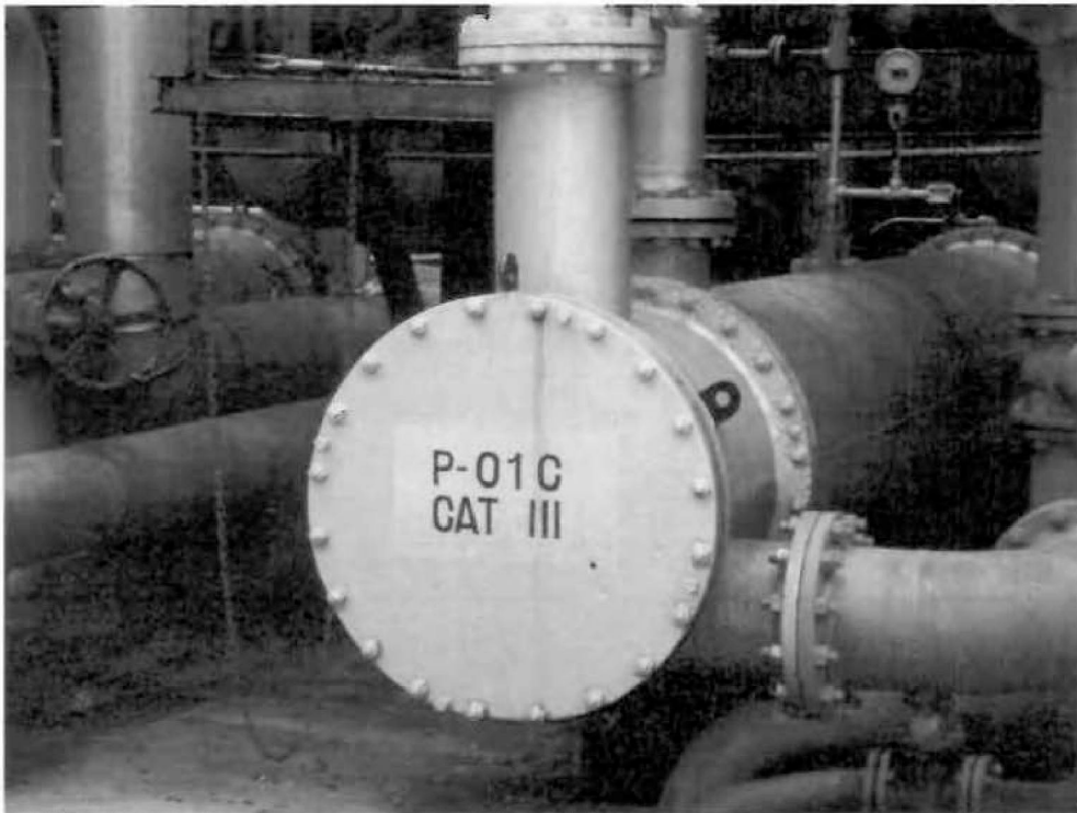
Nº129- P-01 C – Aquecedor de GLP- - fabricante Jaraguá (Área GLP).
