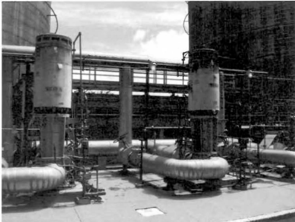
Nº 187- MB-01 A/B/C – Bombas verticais Worthington – vazão 690m 3 /h, motor GE 300 hp (área GLP)- Moto Bomba B, desativada.
