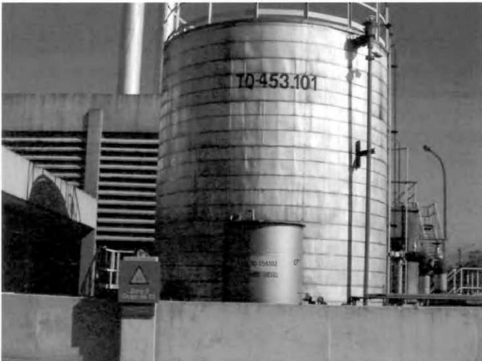
Nº 321- TQ 453101- Tanque para armazenamento de óleo combustível. Capacidade= 100 m 3 (Área TDC)
