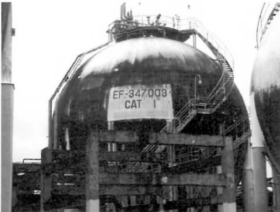
Nº 216/1- EF- 347003- Esfera de GLP, capacidade = 3.193 m 3 (Área GLP).
