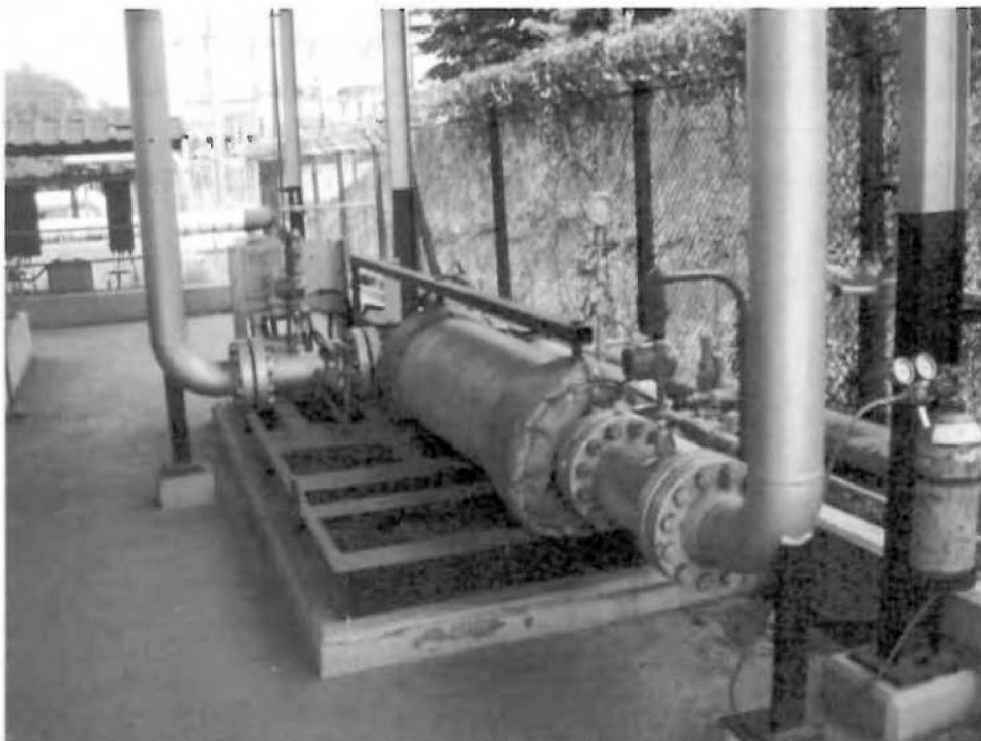
Nº115/1- Turbina da Estação de Medição (PROVER-01) (Área TDC).
