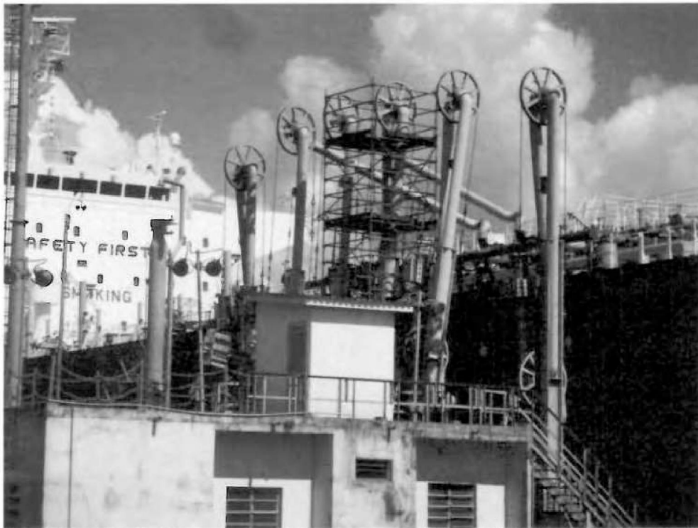
Nº 157- BC- 28002 A - Braço de carregamento Woodfiel.-Ponto 2 (área PIER).
