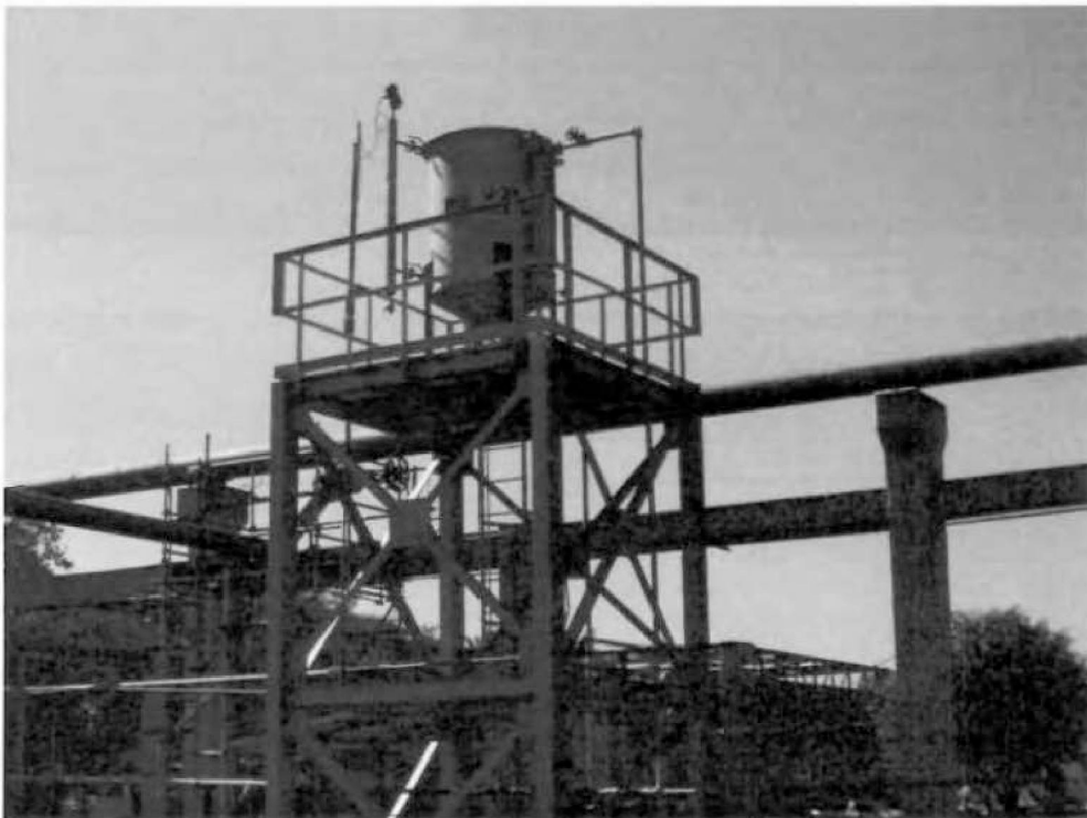
Nº 212- V-33 – Vaso de reposição de etilenoglicol. (Área GLP).
