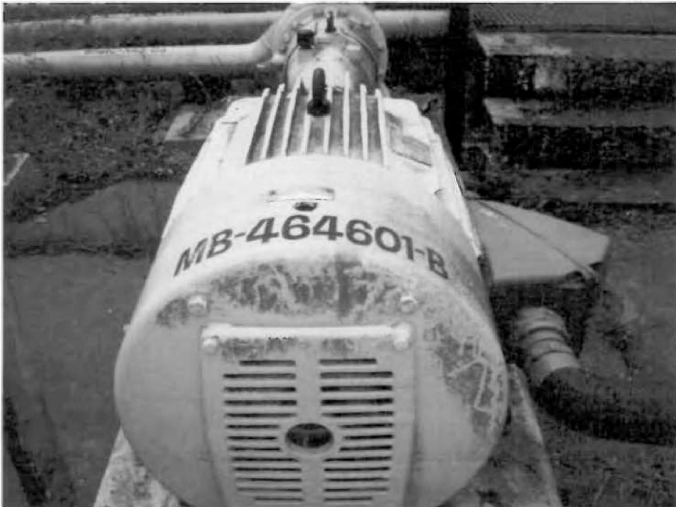
Nº 300- B 464601 A/B – Bomba de 75 cv, vazão 90 m 3 /h, motor GE 75 hp. (Área SAO).
