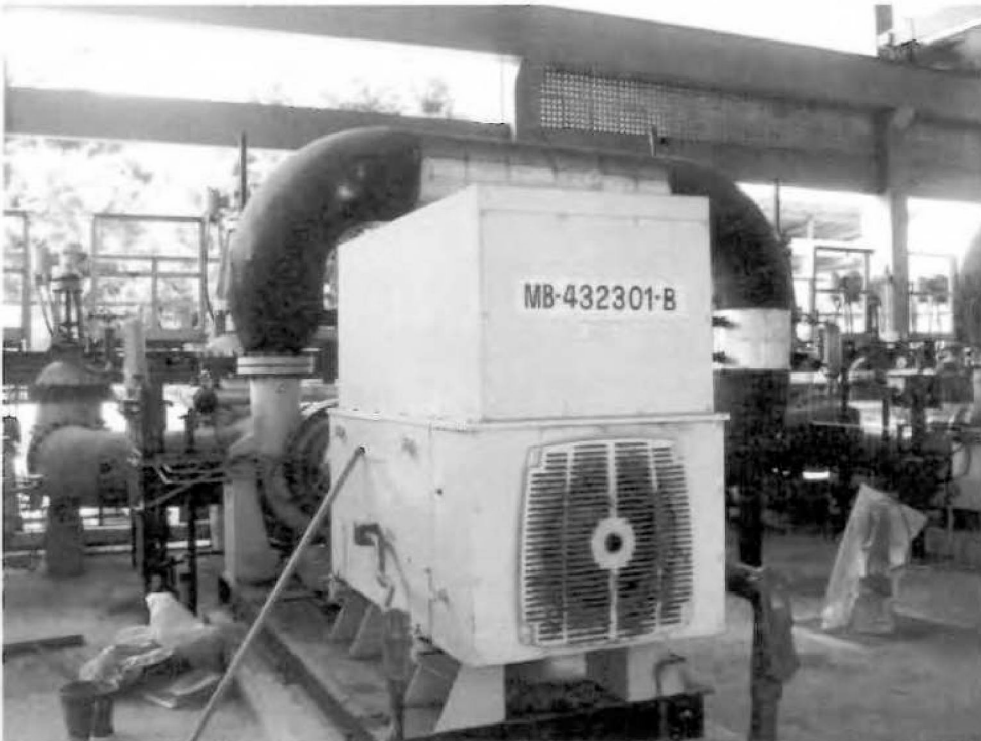
Nº 222/1- B-432.301/B- Bomba Sulzer cent. Horiz. de 700 cv, motor GE 700hp (Área TDC).
