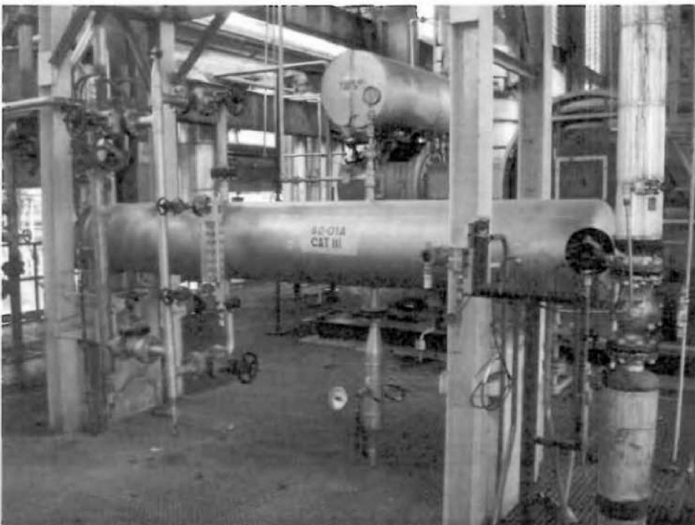
Nº73- Reservatório de Propano – SD- 01A/B/C/D - (Área: GLP) Peso vazio= 640 Kgs.
