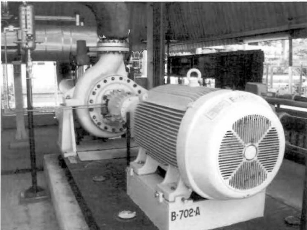
Nº 226/2- B-432702/A- Bomba KSB, vazão 500m 3 /h, motor WEG 250 hp. (Área TDC) – produto Bunker.
