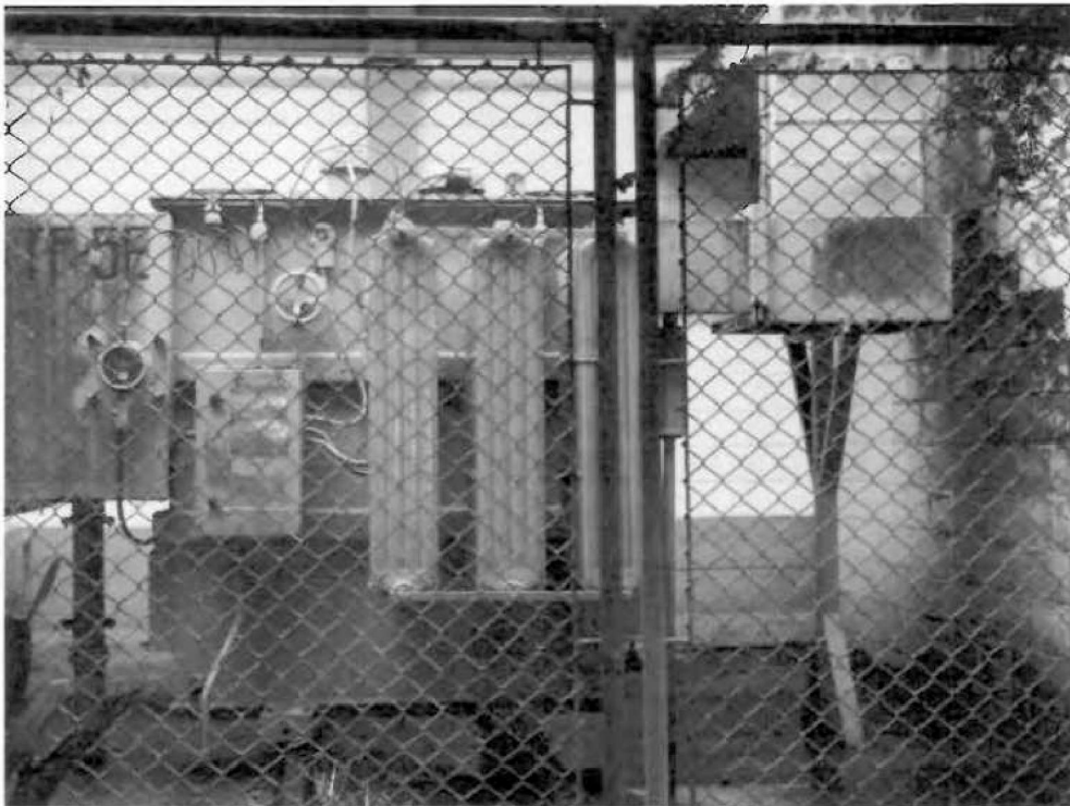
Nº 161- TF-5 E/F – Transformador ITEL PTOCS –5000 Kva(LN) e 6250 Kva (VF) (Área GLP).
