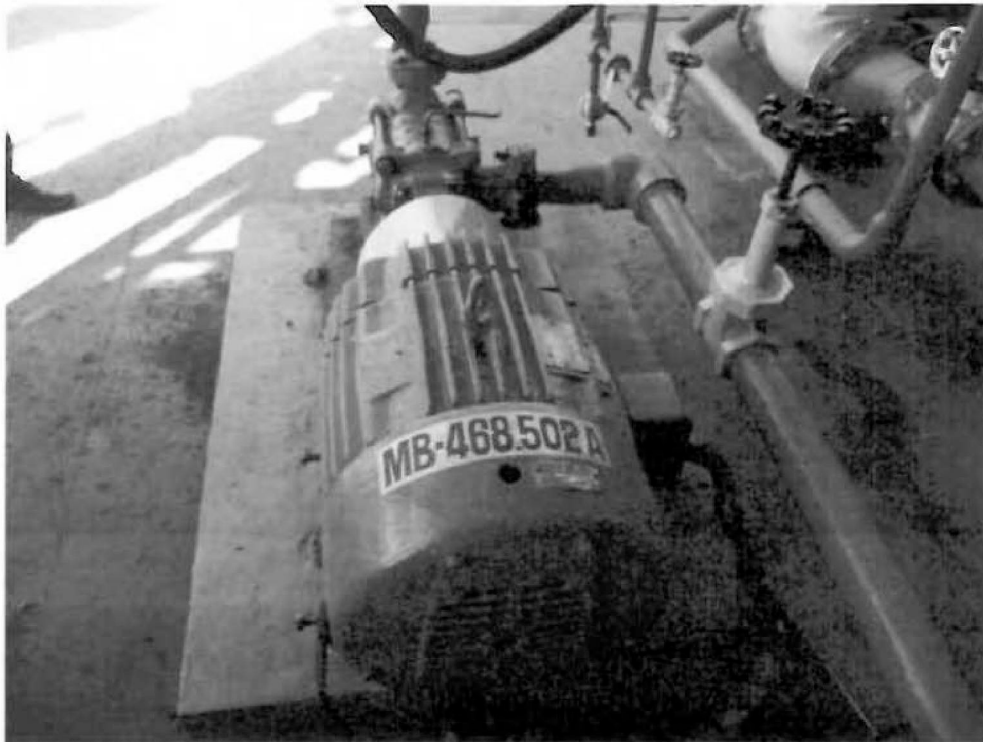
Nº 147- B- 468502 A/B – Bomba Sulzer de 20cv- combate a incêndio (Área TDC).
