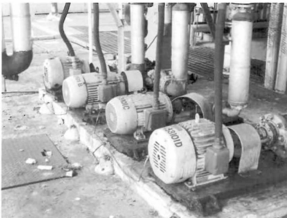
N° 239- B-453101 A/B/C/D- Bombas cap= 20hp, vazão= 19,3 m 3 /h. Motor GE de 20hp. (Área TDC).
