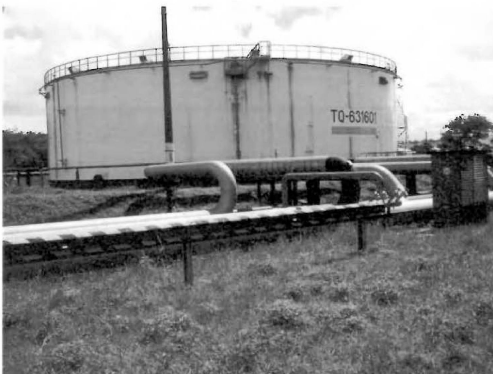
Nº 313- TQ 631601- Tanque para armazenamento de óleo diesel. Capacidade= 9.484 m3 (Área Alemoa).
