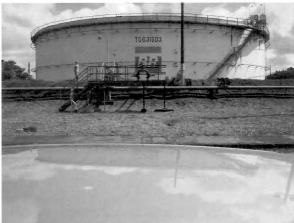
Nº 312- TQ 631503- Tanque para armazenamento de gasolina. Capacidade=22.500 m3 (Área Alemoa).
