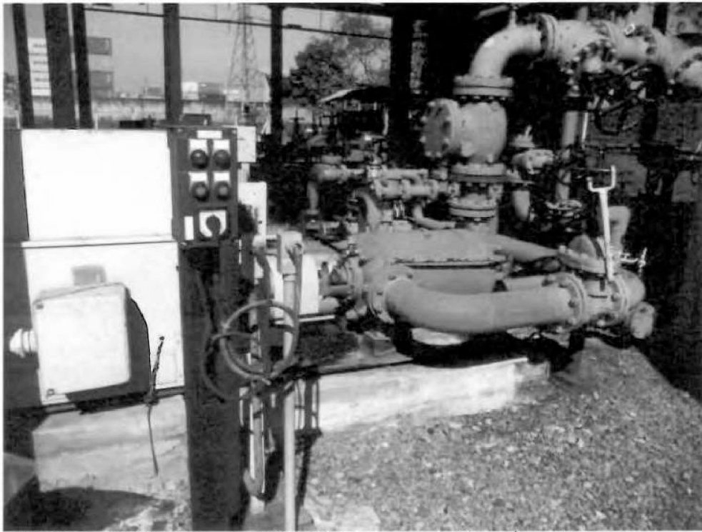
Nº138- B-451803 – Bomba KSB 200cv- motor 200cv (Área TDC).
