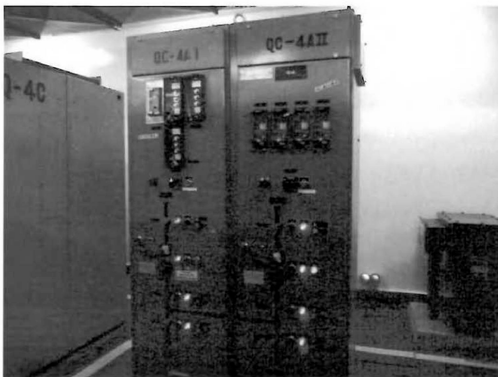
Nº256/1 - Q 4 A – Quadro de força – Promon de 4,16 Kv, 10 saídas. (Área TDC).
