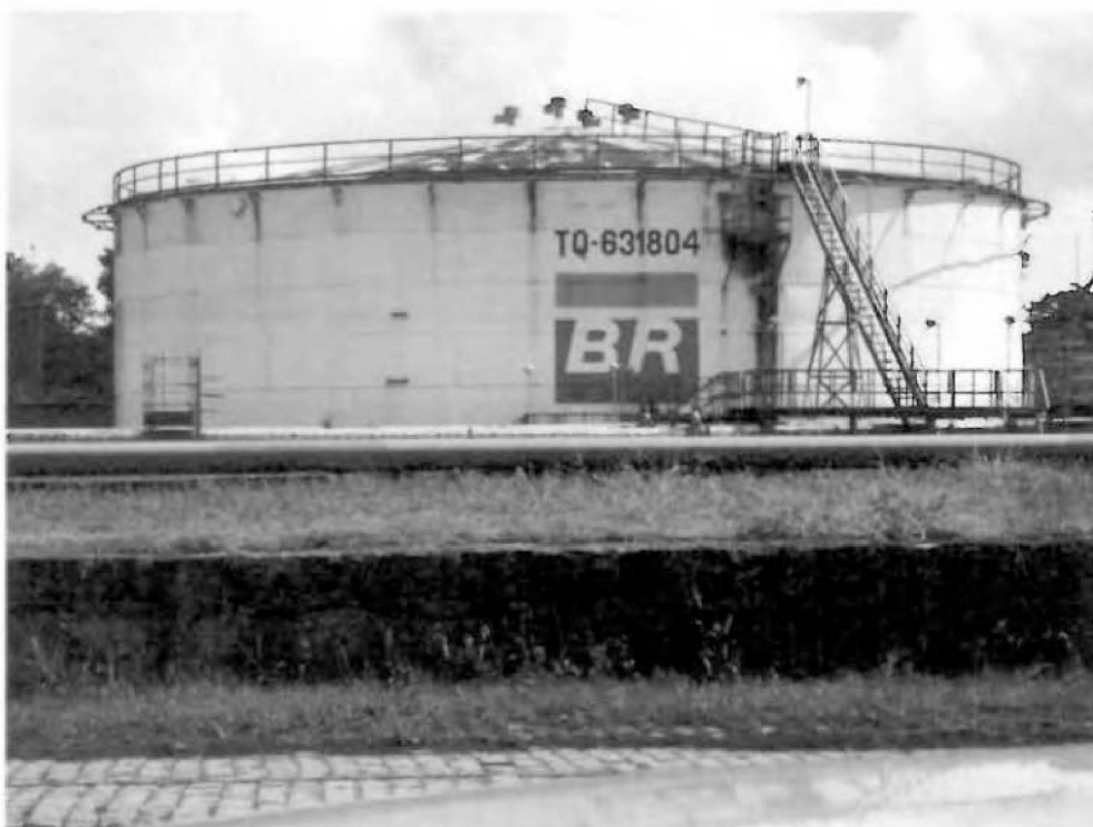
Nº 331- TQ 631804- Tanque para armazenamento de óleo Diesel (MGO). Capacidade= 5.400 m 3 (Rua 1- Entrada da Área Industrial)
