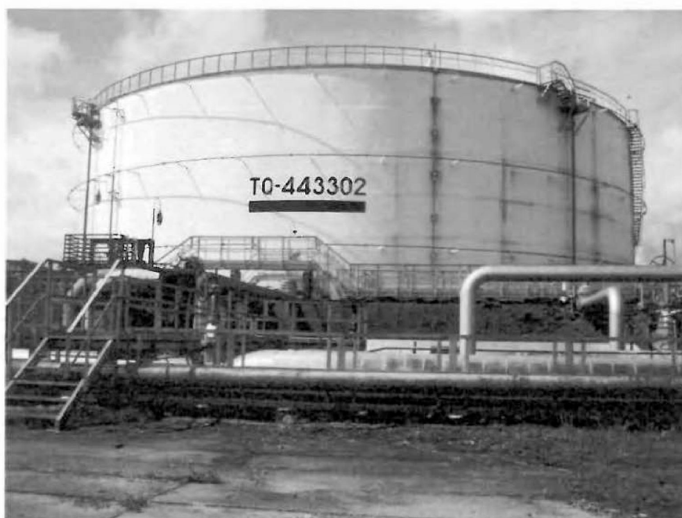
Nº 307/I- TQ 443302- Tanque para óleo combustível, com agitadores. Cap. 22.4659 m3. (Área TDC).
