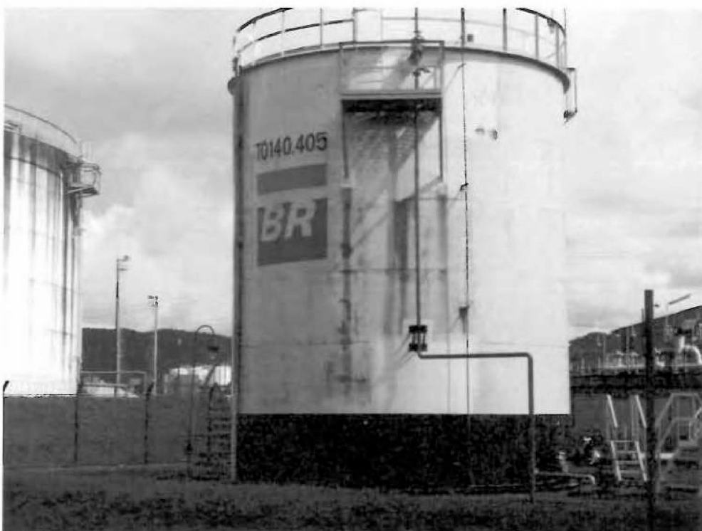
Nº 319- TQ 140405- Tanque de armazenamento de produtos claros Capacidade= 400m3 (Área COTAL).
