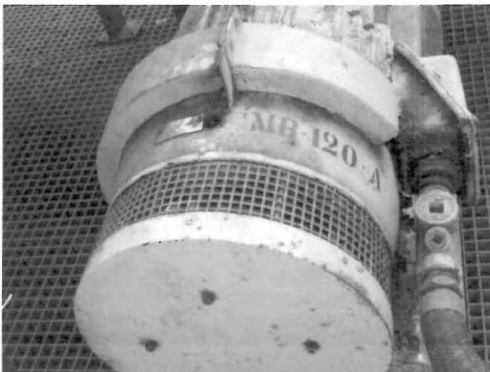
Nº120- B-120A/B- Bombas Worthington (sis. de água da casa de maquinas) (Área GLP).
