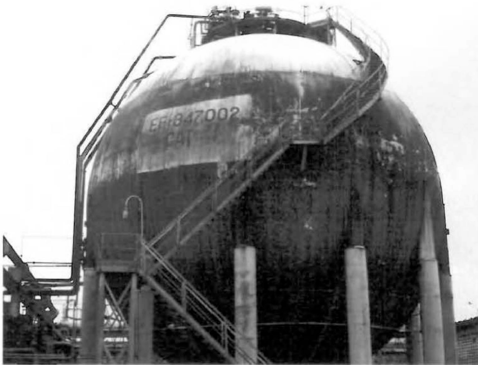
Nº 216- EF- 347002- Esfera de GLP, capacidade = 3.193 m 3 (Área GLP).
