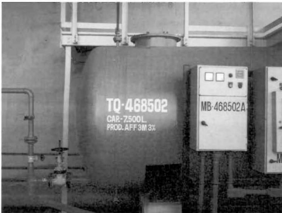
Nº 148- TQ- 468502- Tanque de LGE- cap. 7,5 m3 – (Área TDC).
