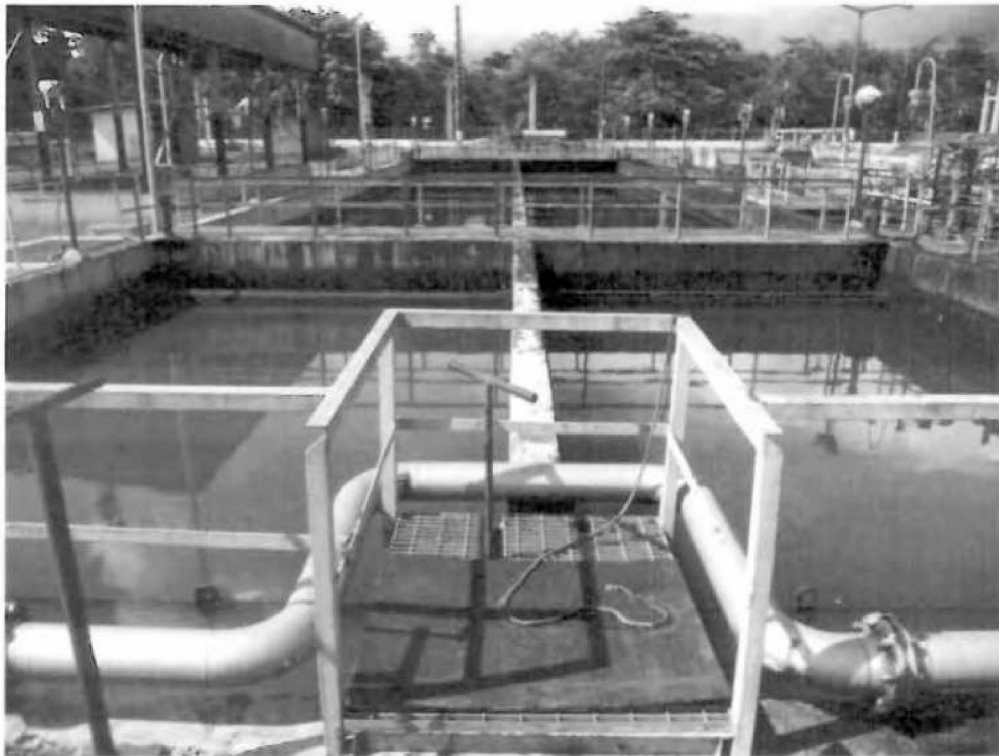
Nº.4 – S.A.O. – Separador de Água e Óleo
