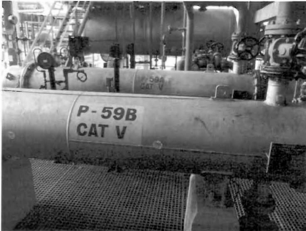
Nº123- Permutador de água, fabricante GEA (Área GLP). Peso vazio= 1713 kgs
