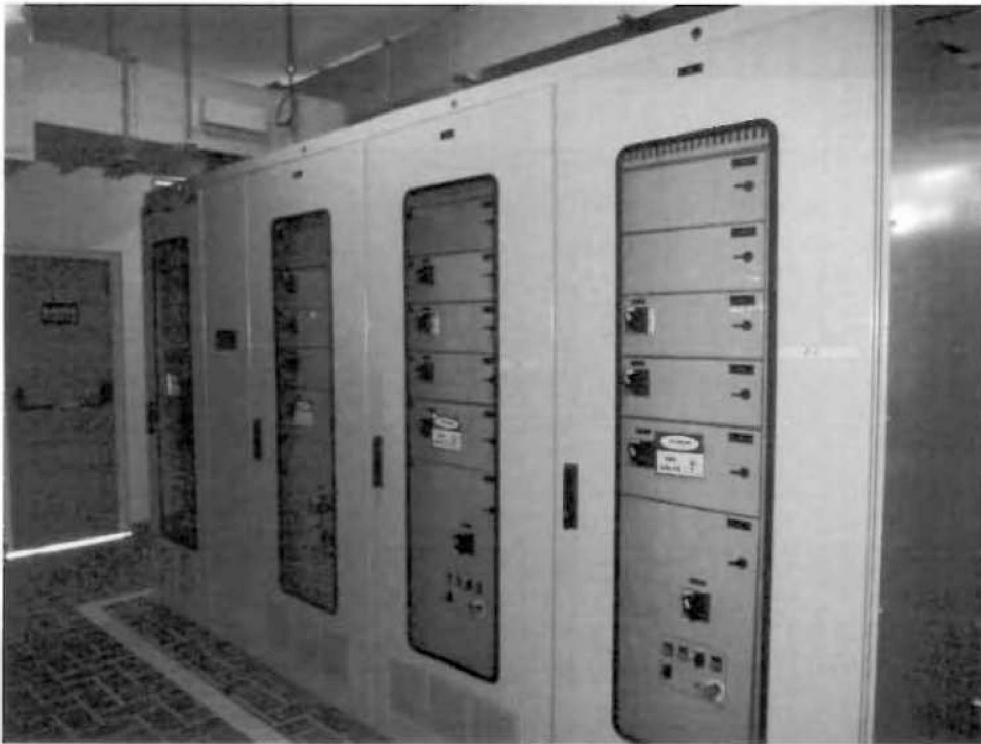
Nº256/2- CCM do TDC- Quadro instalado em 2008 – 06 saídas. (Área TDC).
