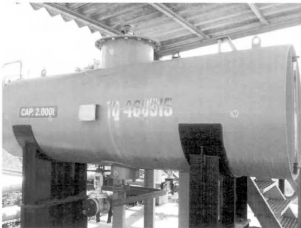
Nº 317- TQ- 468515- Tanque de LGE, cap. 2 m3 (Área TDC).
