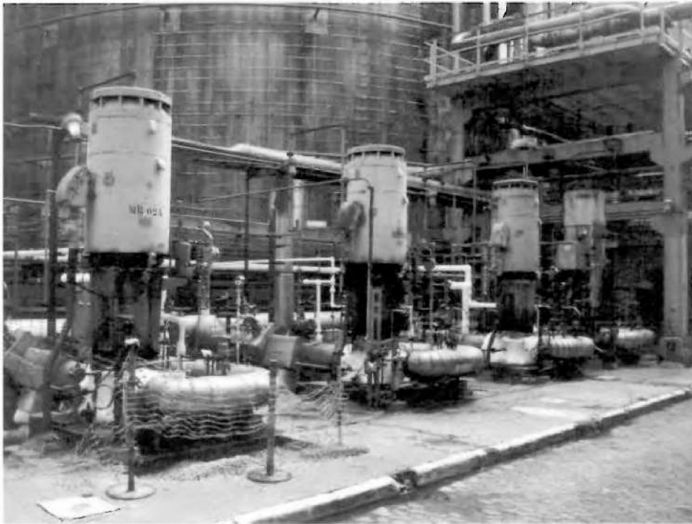
Nº 189- B-02 A/B/C/D–Bombas verticais Worthington, vazão 310 m 3 /h, Motor GE 250HP. (Área GLP).
