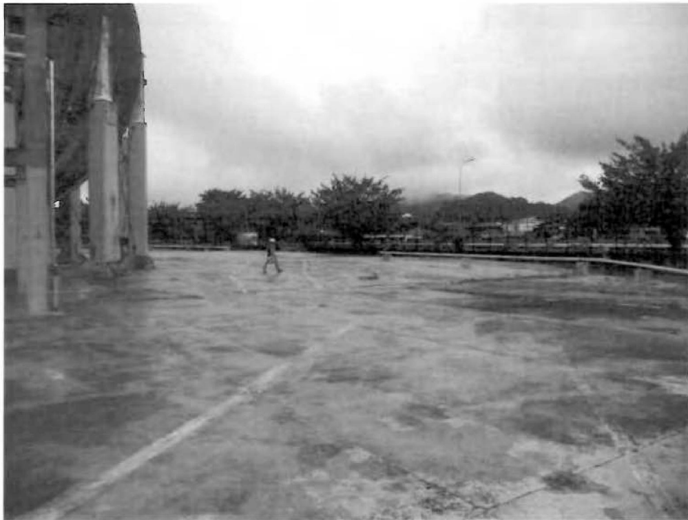
Nº.58 – Bacia de contenção de GLP
