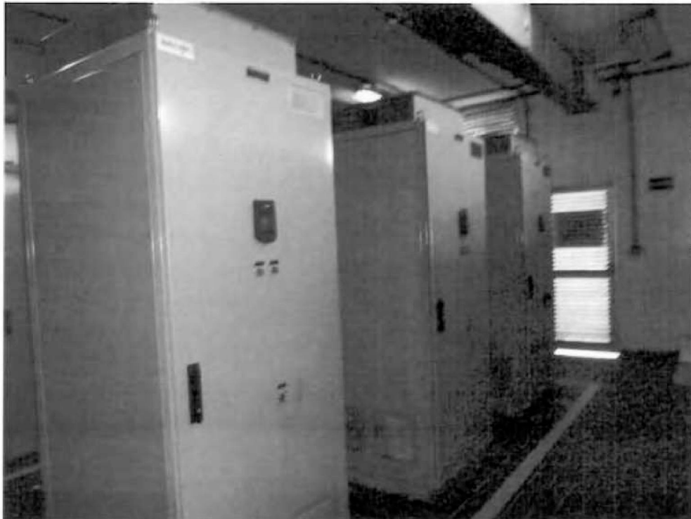
Nº256/3- CCM do GLP Quadro instalado em 2008.- 06 saídas. (Área GLP).
