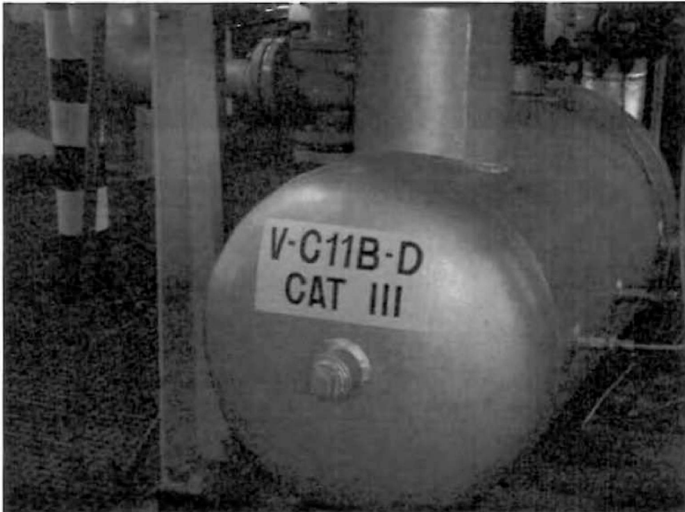
Nº 205- C-11 A/B- Compressor Ingersoll Rand ESH-1 NL-2, vazão 1333 m 3 /h (Soprador de GLP (Área GLP)).
