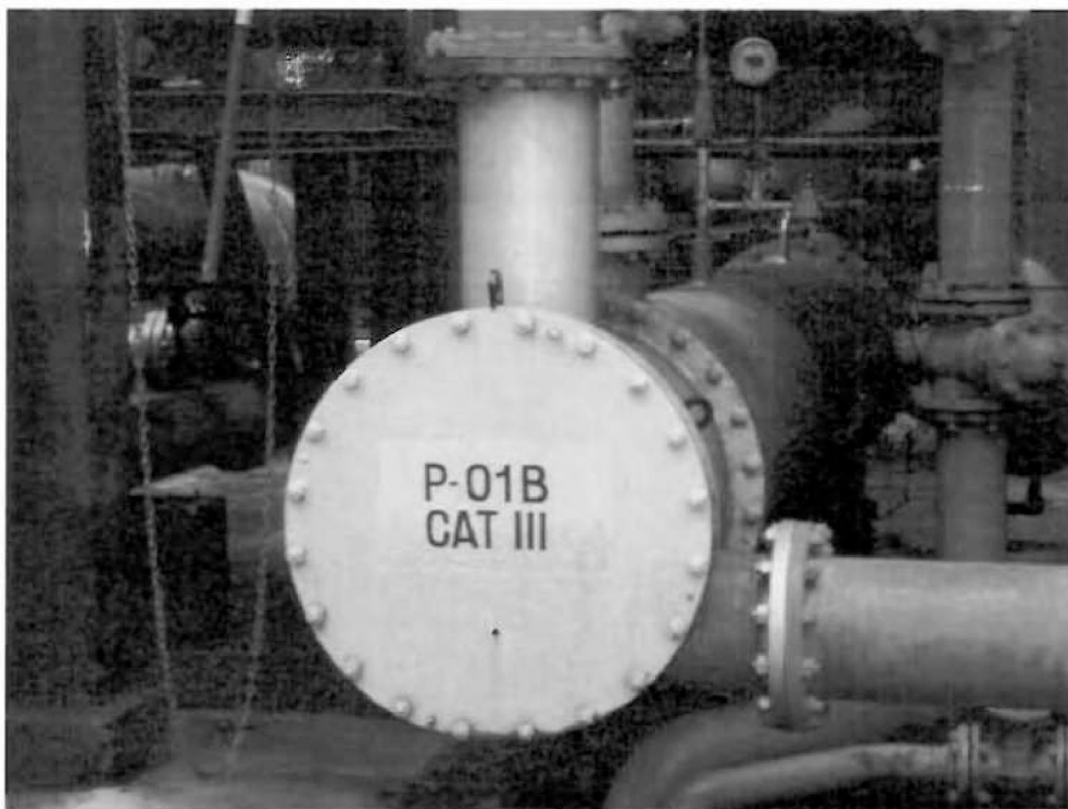
Nº128- P-01 B- Aquecedor de GLP -- fabricante Jaraguá (Área GLP).
