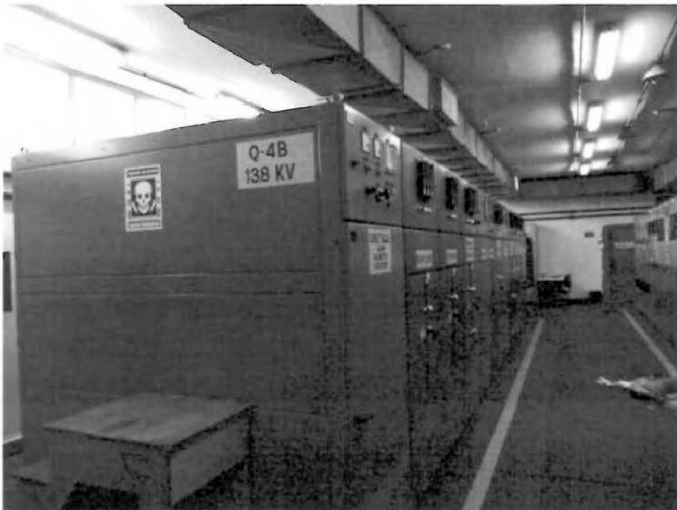
Nº 255- Q 4 B – Quadro de força – SACE de 15 Kv, 06 saídas 20 MVA – 7 MVA (Área TDC).
