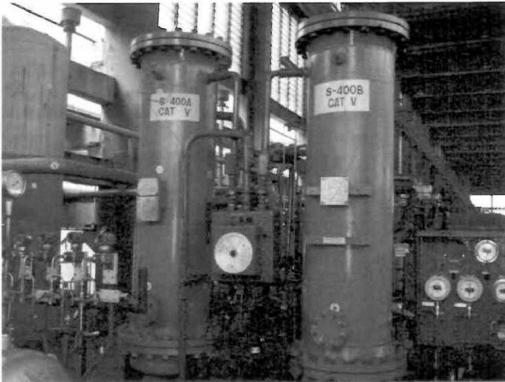
Nº111- S-400 A/B – Secador de corpo cilíndrico – (Área GLP) Peso vazio= 750 Kgs
