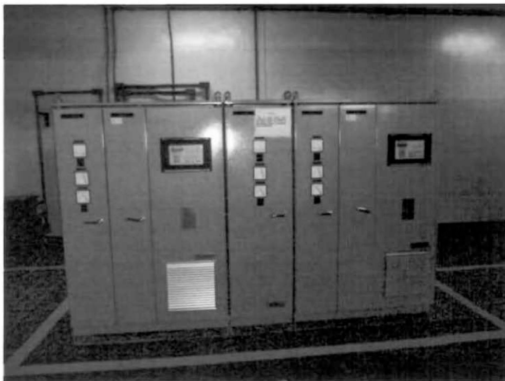
Nº256/4- CCM do PIER- Quadro instalado em 2008.- 06 saídas. (Área PIER).
