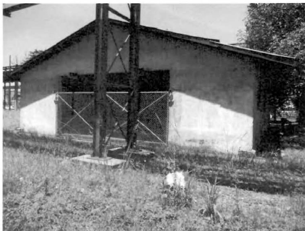
Nº.70(civil) – Casa de Bombas Recalque CODESP ( próx. à guarita do Pier)
