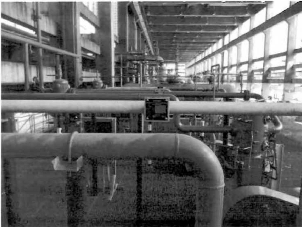
Nº112- P- 400A/B/C – Permutador de calor, tipo casco tubo. (Área GLP)
